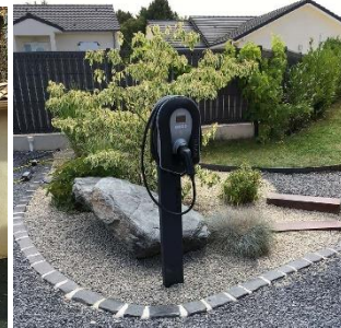
Borne de recharge électrique (parkings collectifs ?)
